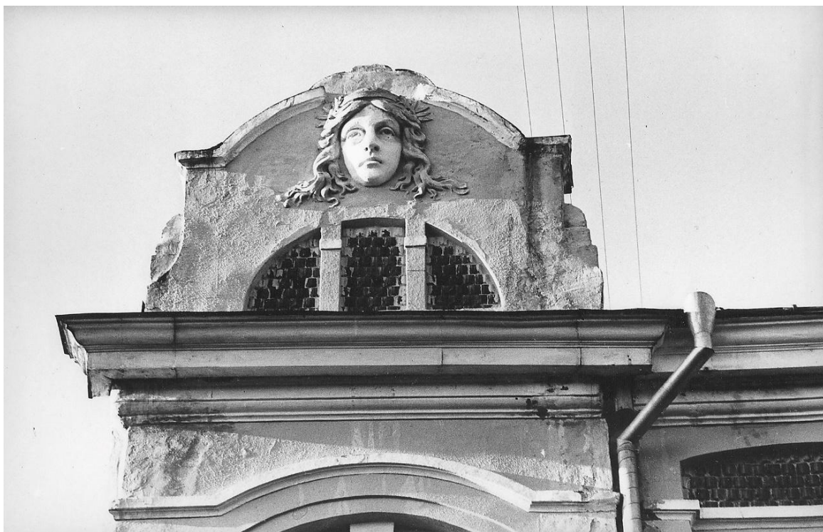
Рис. 3.1.33. Маскарон та склоблоки аттику будинку № 5-7-9, вул. Курбаса, м. Івано-Франківськ. Стан до початку проведення реставраційних робіт
