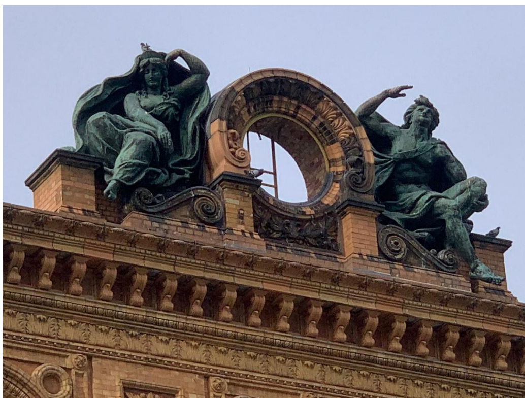
Рис. 3.1.52. Збереження фрагменту декоративності фасаду колишньої станції Ангальтського вокзалу, м. Берлін, Німеччина. Стан після проведення консерваційних заходів
