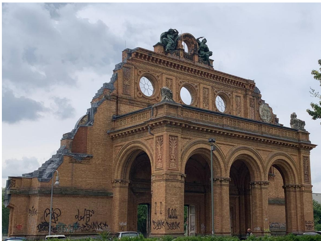
Рис. 3.1.51 Збереження фрагменту декоративності фасаду колишньої станції Ангальтського вокзалу, м. Берлін, Німеччина. Стан після проведення консерваційних заходів
